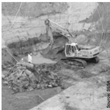
En fond de fouille, l'excavation se poursuit afin de retirer l'ensemble des terres contaminées par les hydrocarbures.
